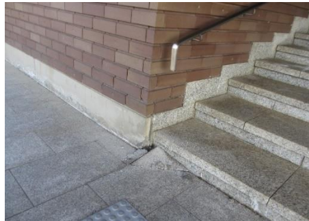
正面玄関外 石畳の破損
